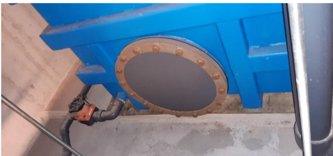
Figuur 4 Corrosie mangat zandfilter
