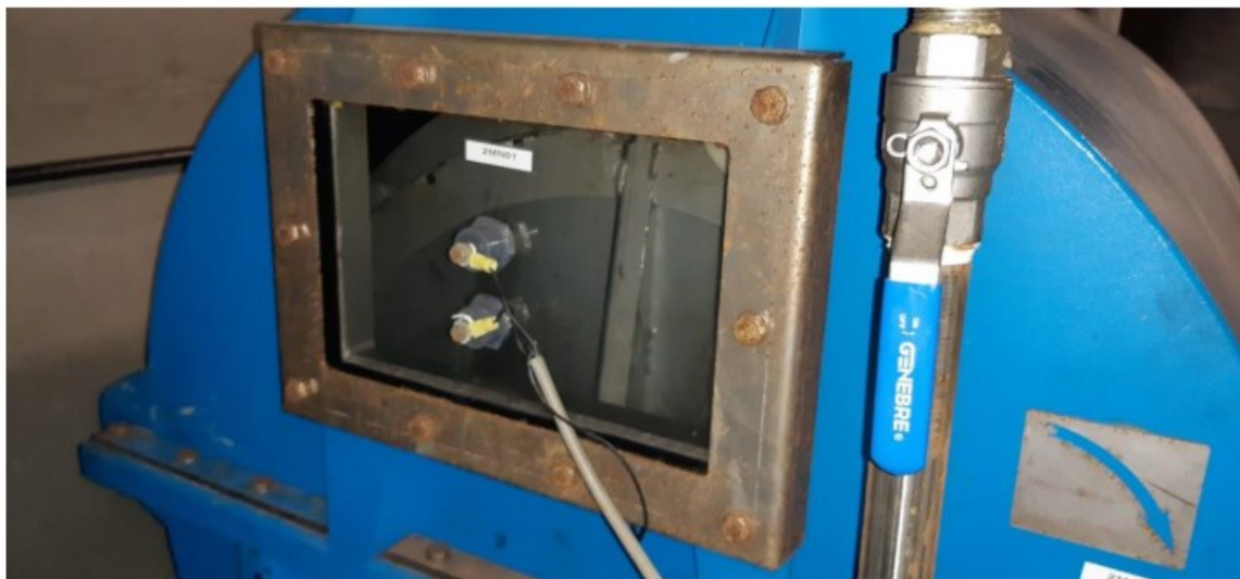
Figuur 3 Corrosie trommelfilter
