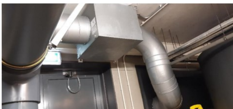
Figuur 8 Ventilatie kanalen
