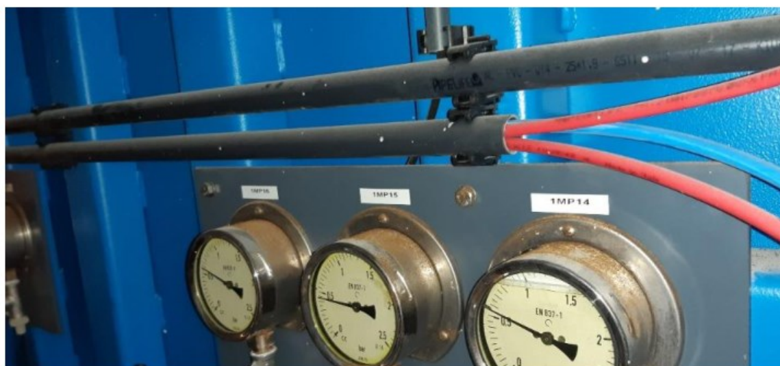
Figuur 2 Corrosie op manometers
